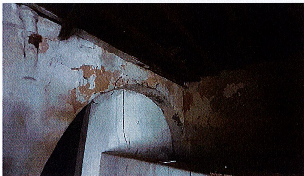
Foto 4 – Deterioração das argamassas de revestimento - Interior do RC
