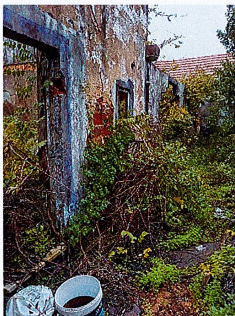
Foto 9 – Construções em mau estado de conservação, desprovidas de cobertura – interior do logradouro
