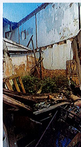
Foto 6 – Existência de lixos, resíduos resultantes de derrocadas e de vegetação no interior do edifício
