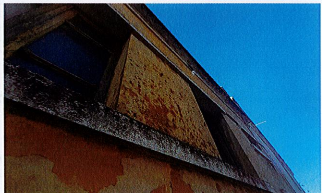
Foto 4 – Presença de manchas de humidade, sujidades e bolores no paramento da fachada
