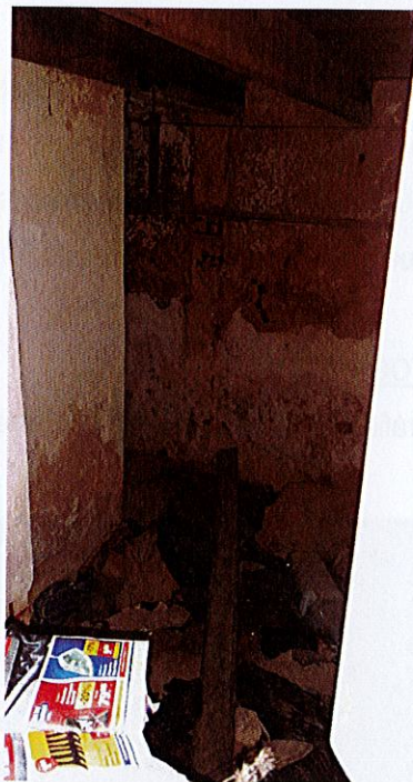
Foto 6 – Existência de lixo, resíduos resultantes de derrocadas e de vegetação no interior do edifício
