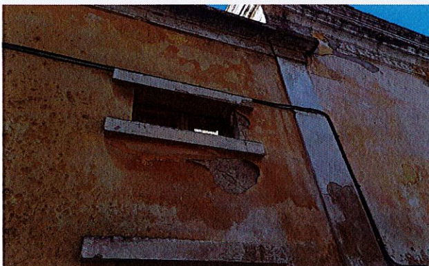
Foto 3 – Empolamento e destacamento da pintura, decorrentes da aceleração do processo de degradação
