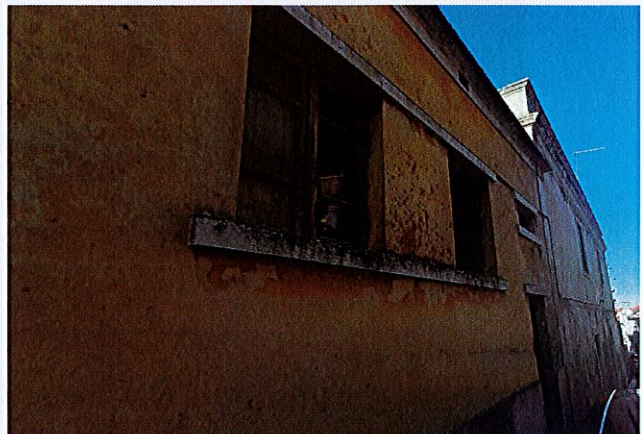
Foto 2 – Caixilharia deteriorada e com vidros partidos
