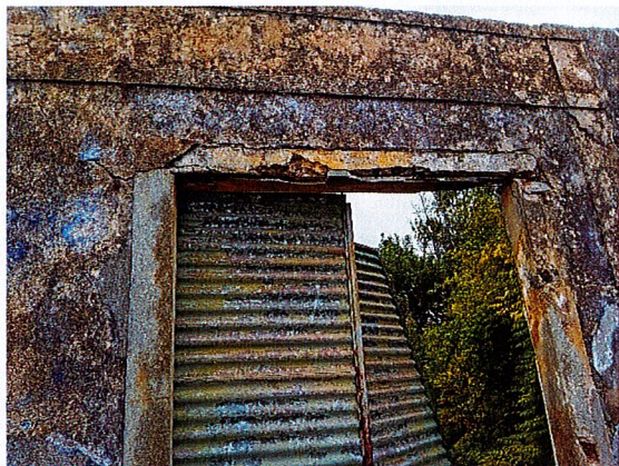
Foto 7 – Portão de acesso ao logradouro em mau estado. Fissuração junto à verga do portão e oxidação dos elementos em ferro
