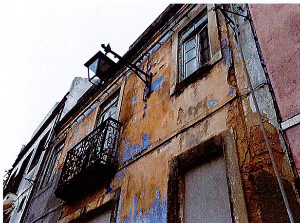
Foto 2 – Paramento em mau estado de conservação. Desagregação da alvenaria de revestimento
