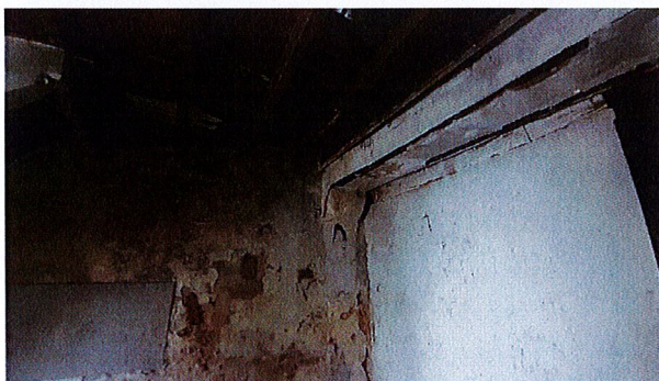
Foto 5 – Oxidação dos elementos em ferro, provocando a fissuração e desagregação das argamassas. Deterioração dos elementos de madeira – Interior RC
