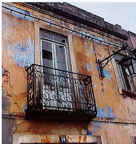
Foto 3 – Oxidação dos elementos em ferro da varanda. Caixilharia deteriorada e com vidros partidos
