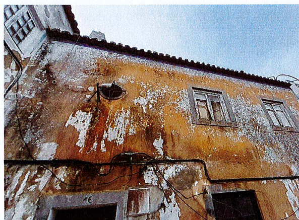
Foto 2 – Caixilharia deteriorada e com vidros partidos, permitindo a entrada da água da chuva e animais. Desgaste e erosão do revestimento
