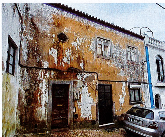
Foto 1 – Vista geral sobre a fachada confinante com a Rua da Saboaria - Deterioração do revestimento, manchas de humidade, musgos e sujidades no paramento
