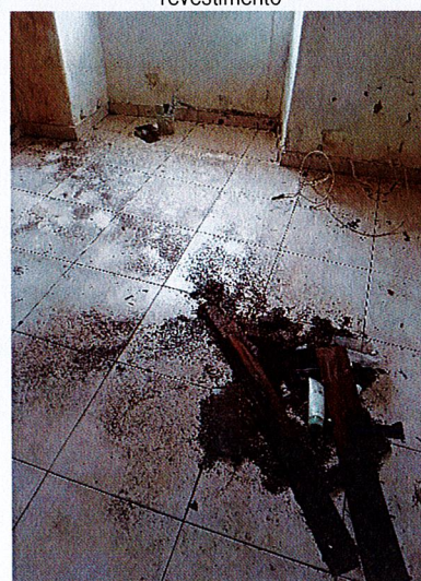
Foto 4 – Deterioração das argamassas de revestimento dos paramentos
