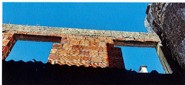
Foto 5 – Vista geral sobre o paramento da fachada desprovido de revestimento
