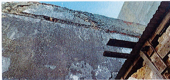
Foto 4 – Fendilhação da parede meeira (norte)
