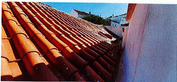
Foto 7 – Deformação da estrutura da cobertura
