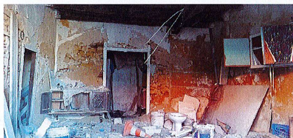
Foto 6 – Acumulação de lixo no interior do prédio
