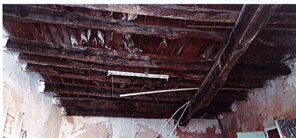
Foto 5 – Apodrecimento e deterioração dos elementos de madeira
