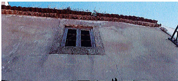
Foto 3 – Telhas de beirado danificadas
