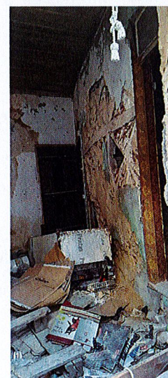
Foto 7 – Paredes de tabique em deficientes condições de segurança/estabilidade
