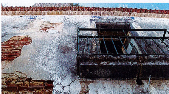
Foto 3 – Ausência de reboco em grandes áreas da superfície aparente dos paramentos existentes. Fratura da laje da varanda.
