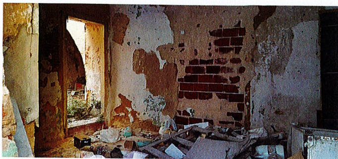
Foto 8 – Fendilhação acentuada, degradação dos revestimentos das paredes
