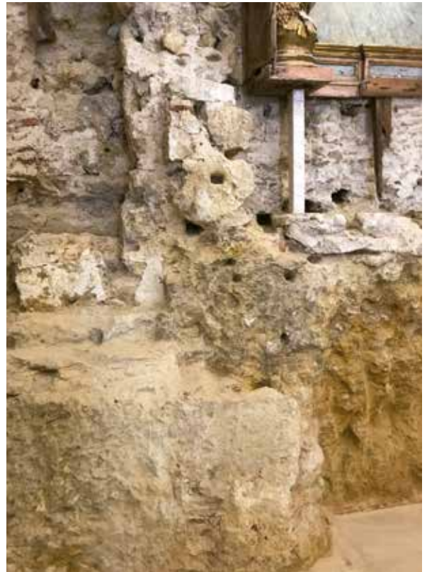
Fig. 1 – Pormenor do tardo do altar e dos vestígios para a fixação do primitivo retábulo
