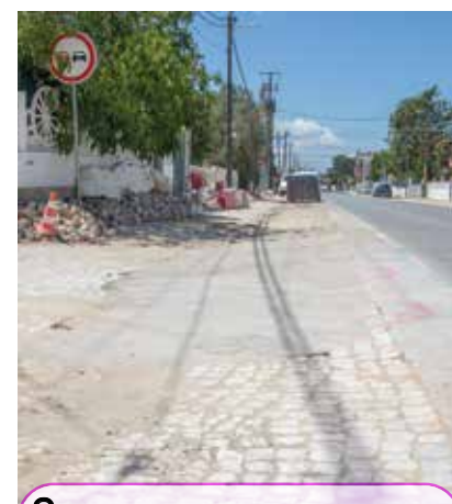
6 Também em conclusão, o alargamento da rede de drenagem de esgotos domésticos ao longo da EN 379-2, na Lagoinha
